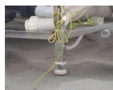
↑ La mise à terre est nécessaire
